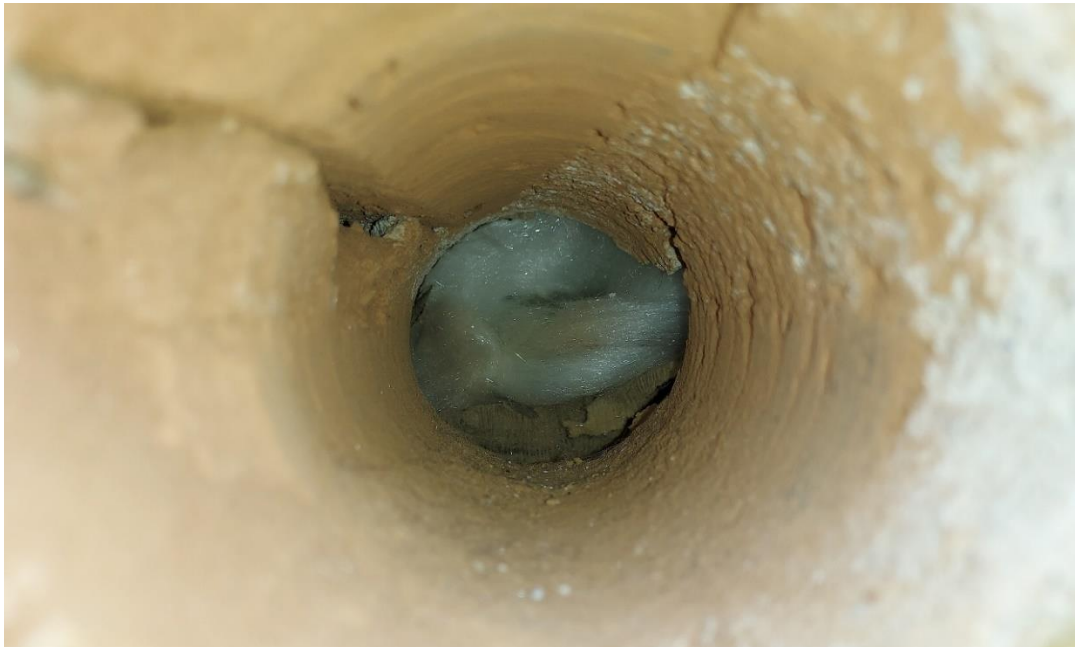
Kuva 2a ja b. Lämmöneristeen havaittiin olevan kuonavillaa. Eriste on levymainen tuote, jonka molemmissa pinnoissa on langoilla toisiinsa kiinnitetty paperi.
