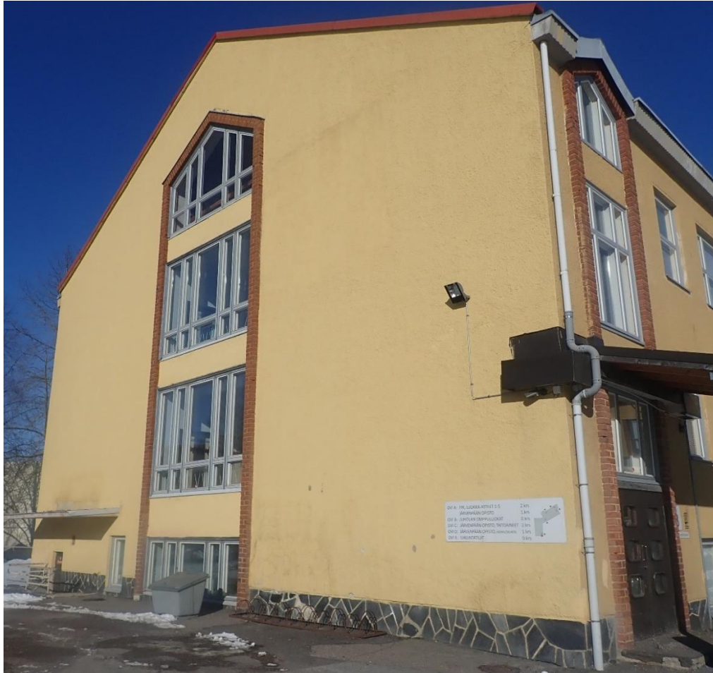
Kuva 5. Koko eteläpääty on pinnoitettu uudelleen ilmeisesti viimeisimpien rappauskorjausten yhteydessä. Pinnoitteen alueella näkyy useita paikkarapattuja alueita.
