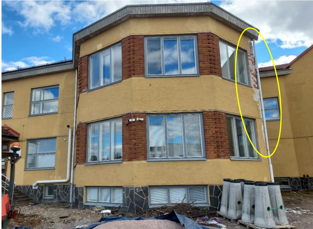
Kuva 3. Pitkäaikaisen räystäsvuodon aiheuttama rappaus- ja tiilivaurio luoteissivulla.
